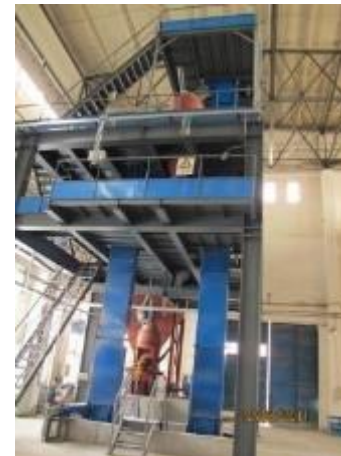
Lit de Test du Broyeur Vertical du Ciment
