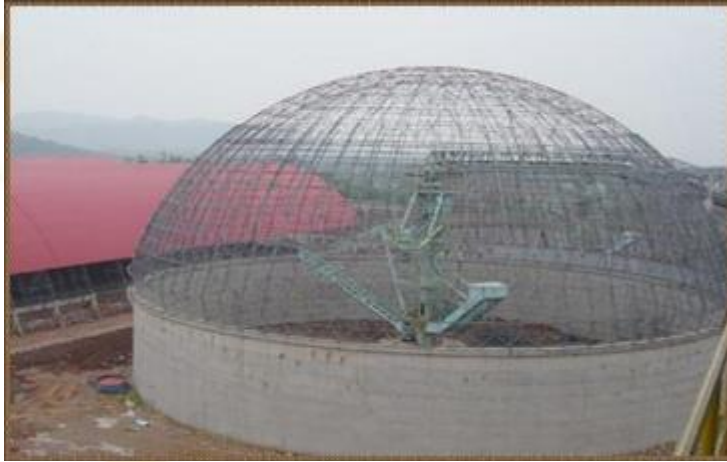
Stockage de Grande Capacité
